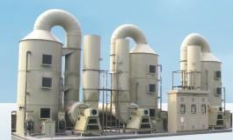
PP廢氣處理洗滌塔
